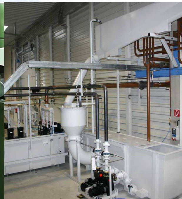
Zbiorniki z chłodziwami
